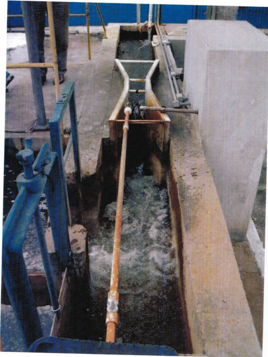
Figura 15: Vista da aplicação da mistura rápida na calha Parshall - ETA – Sede.
