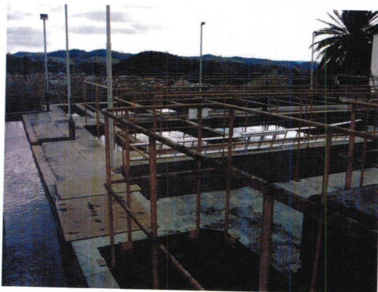
Figura 14: Vista geral das unidades de Tratamento de Água - ETA – Sede.
