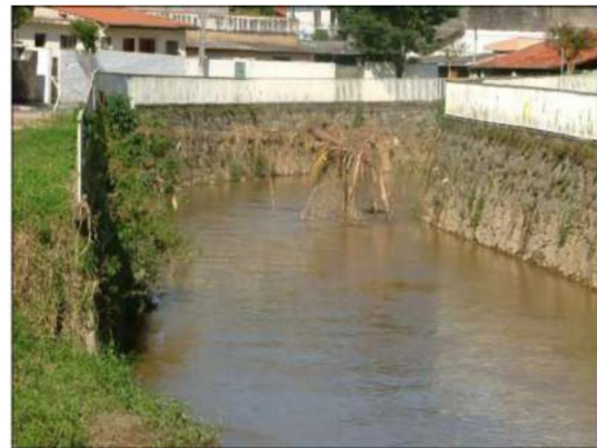
Figura 18 – Obstrução do canal
