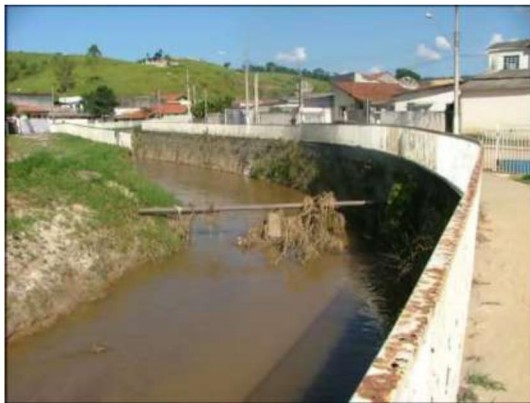
Figura 17 – Obstrução do canal
