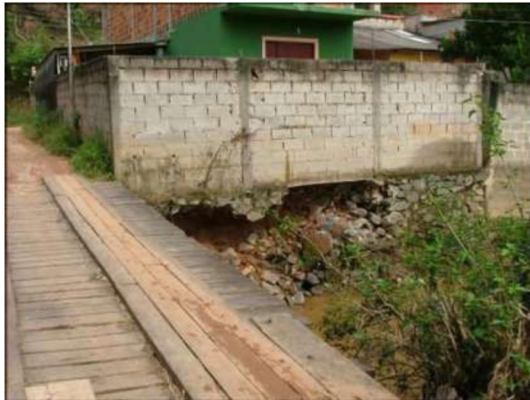
Figura 9 – Ocupação irregular e danos estruturais
