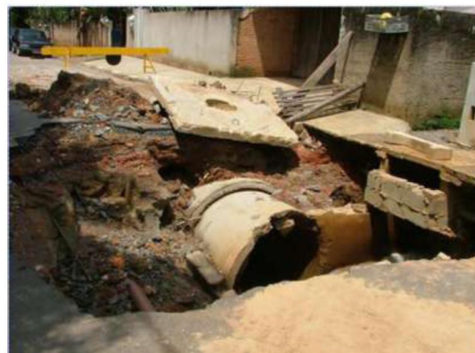
Figura 73 – Rompimento da linha de tubos na Rua Manoel Sanches Moyano
