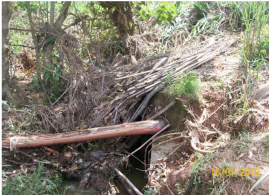
Figura 48 – Passagem obstruída sob a estrada do bairro da Estiva
