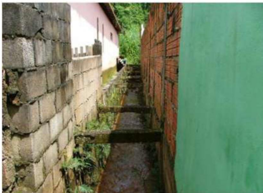
Figura 72 - Passagem do córrego entre duas residências
