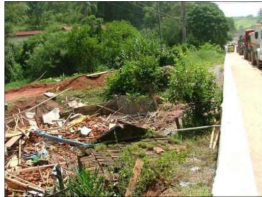
Figura 35: Resíduos da madeira que provocou entupimento da passagem de água.
