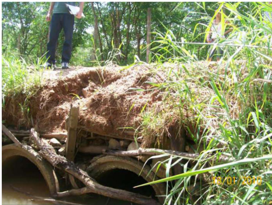
Figura 61 - Vista da tubulação semi assoreada na passagem sob a Estr. Elvira Santana Cardoso.
