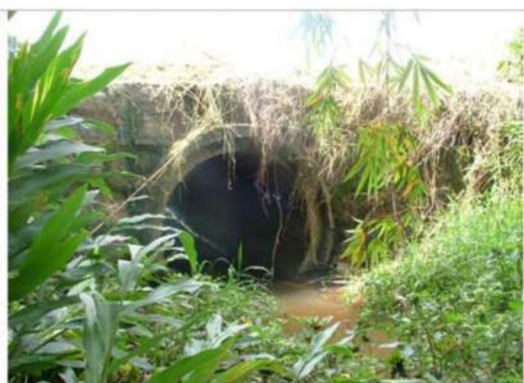
Figura 29 – Entrada da tubulação
